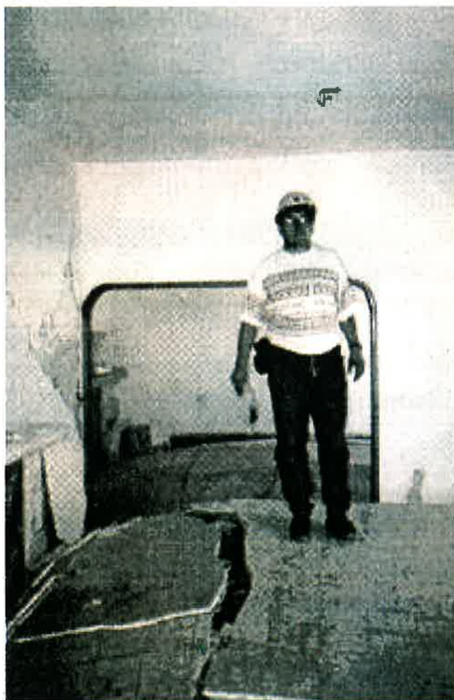
Figura 1.24. Losas levantadas por el efecto de licuación en el sismo de Manzanillo, 1995.
