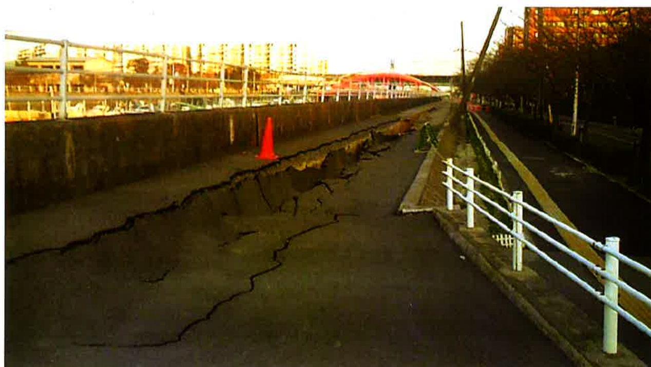
Figura 1.19. a) Hundimientos en el terreno debido a licuación.
