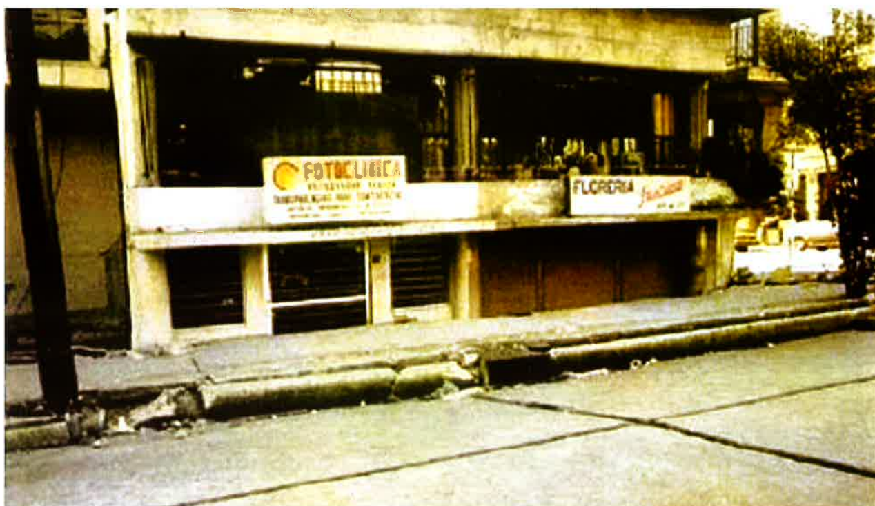
Figura 1.18.c) hundimiento de edificio en el sismo de Colima, 1995.
