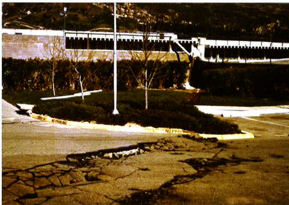
Figura 1.17. a) Fisuras en el terreno debido a licuación, sismo de San Fernando, California.
