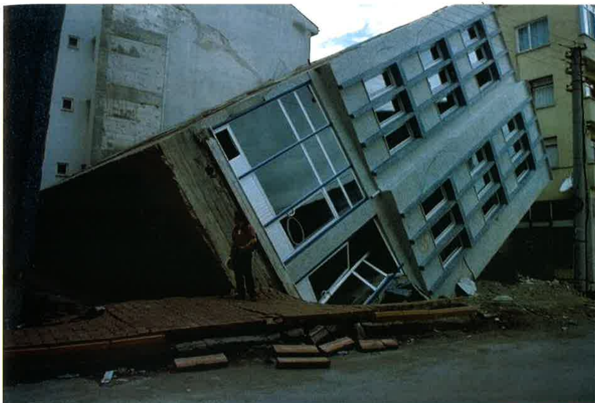
Figura 1.18. a) Volcamiento de edificio durante el sismo de Izmit, Turquía, 1999.
