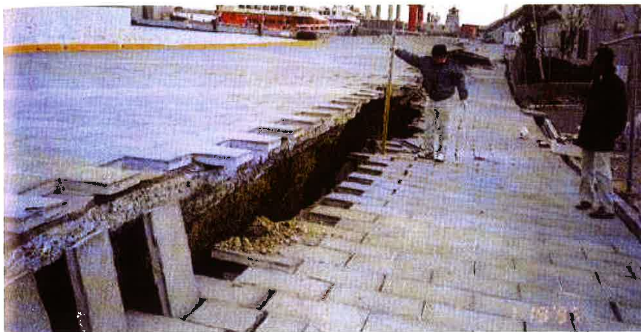
Figura 1.19. b) Hundimientos en el terreno debido a licuación.
