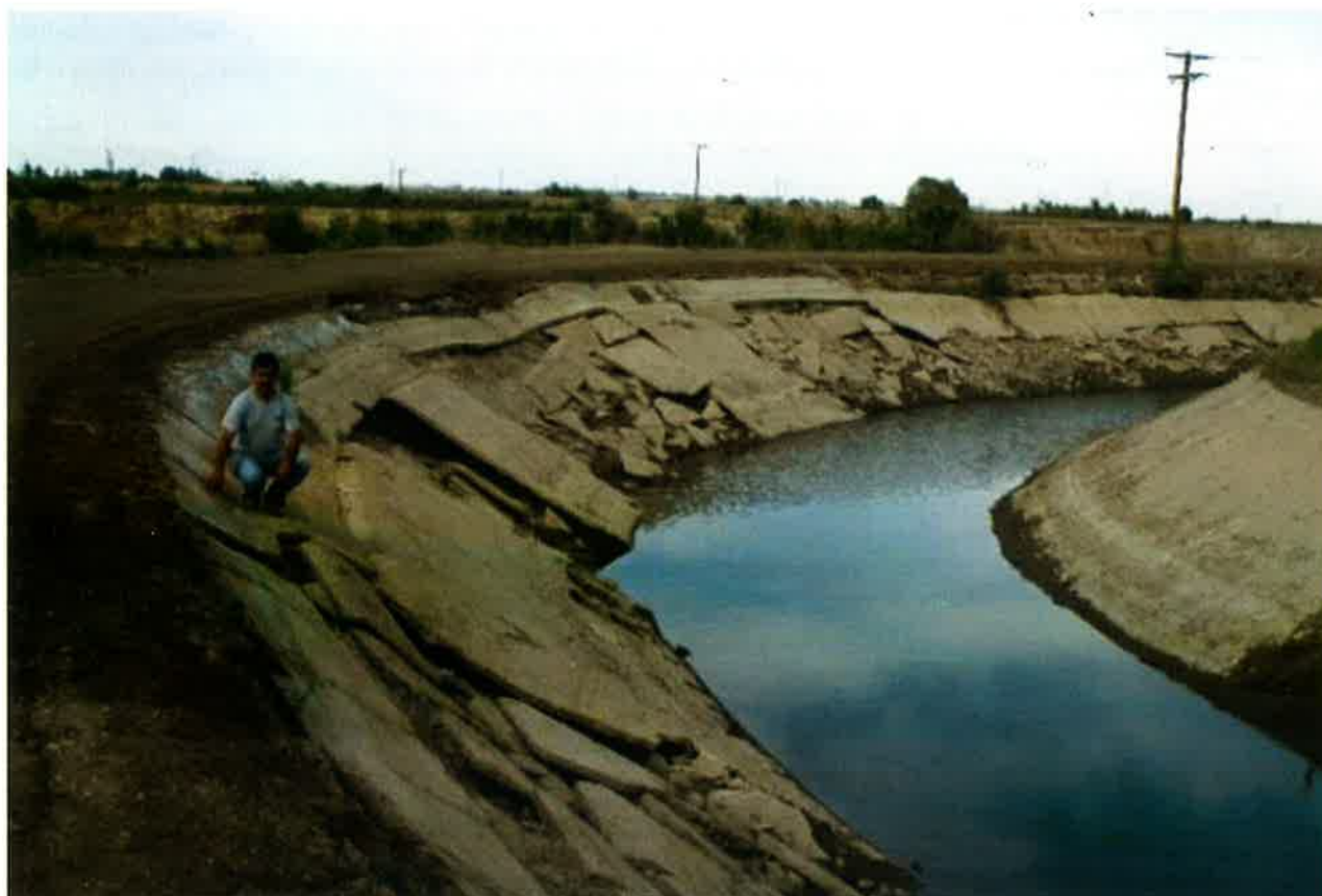
Figura 1.25. b) Evidencias y daños provocados por el fenómeno de licuación en el Valle de Mexicali, 2010.
