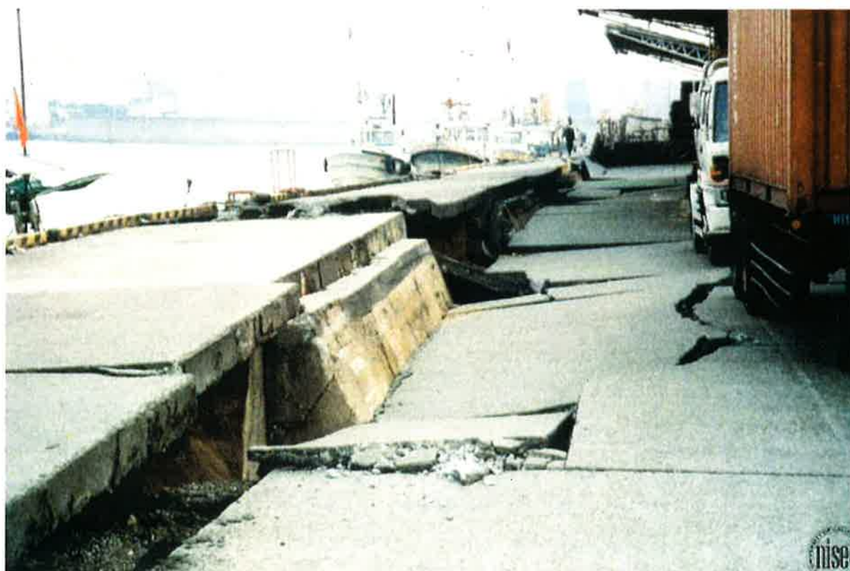
Figura 1.18. b) hundimiento detrás del muro de un muelle durante el sismo de Kobe, Japón 1995.
