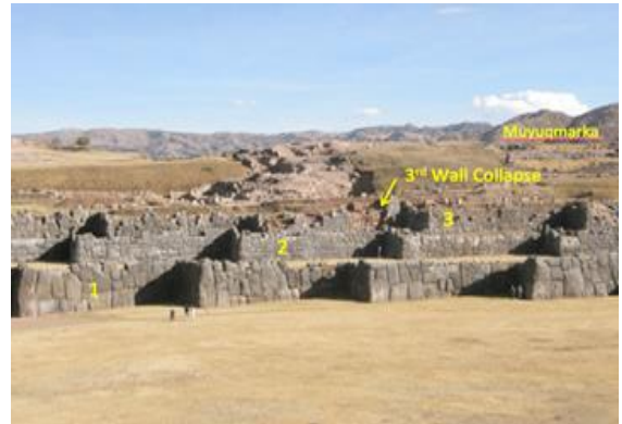
Fotografía N°02: Se observa la ubicación de muros que colapsaron
