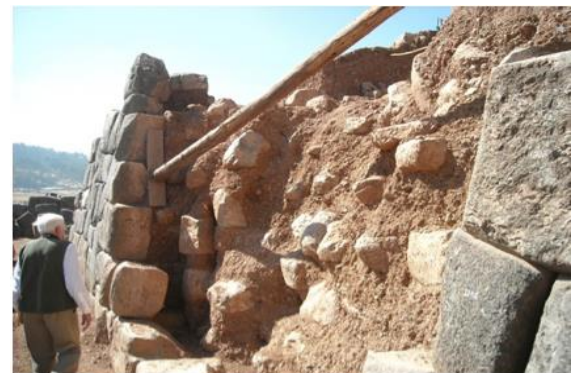
Fotografía N°03: Se observa muro inca que colapsó
